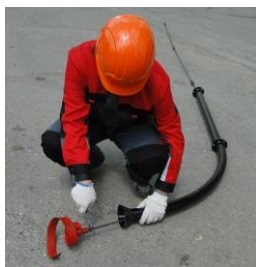
Вставить в направляющую трубу вал, собранный из прочистных стержней, соединить с насадкой
